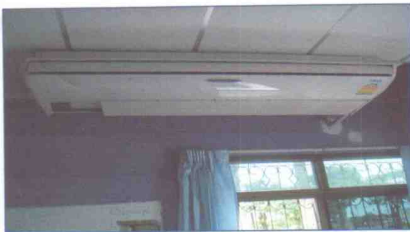
14. จัดซื้อเครื่องปรับอากาศ
